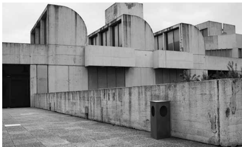
Deterioros existentes en lucernarios, muretes y paramentos de la Fundació. En los muretes de la terraza también se aprecian los desprendimientos de material, las grietas y las varillas oxidadas. Foto: MEC, julio de 2002
