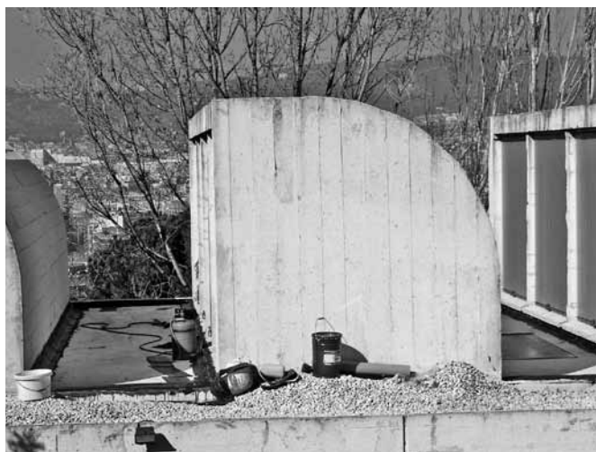
Detalle de los daños que presentaban los lucernarios y los muretes de las terrazas de la Fundació. Obsérvese el escaso recubrimiento entre el concreto de la cara exterior y las varillas. Esto provocó oxidación en los elementos metálicos y una gran cantidad de fisuras y grietas, tanto en los cuartos de bóvedas como en los pretilos. Uno de los criterios aplicados fue la reparación de todas las superficies de concreto utilizando materiales similares a los existentes. Además, se repararon las pendientes y se impermeabilizaron todas las cubiertas mediante una lámina elastomérica, sobre el que se colocaron las piezas del pavimento. Foto: MEC febrero de 2008.
